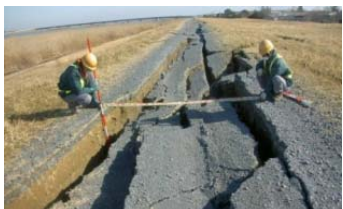
東日本大震災の被災状況(常陸利根川)
