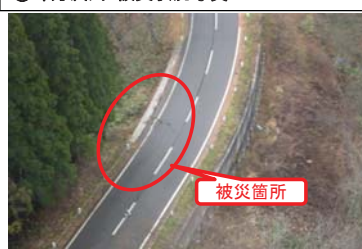
②国道406号:被災状況写真
