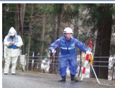
被災状況調査、仮復旧の提案
