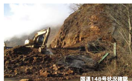
国道148号状況確認
