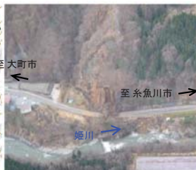
現地付近の航空写真(被災状況)
