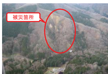
①峰方沢川:被災状況写真
