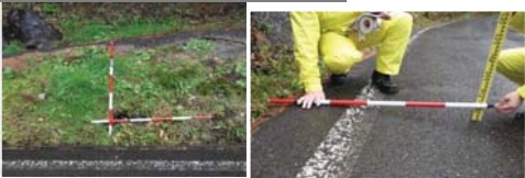
蔵平地区被害状況(村道舗装面の浮き上がり)
