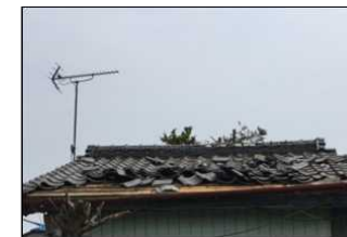
②屋根瓦がめくれた住家
