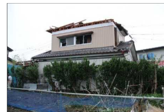
①屋根が飛んだ住家
