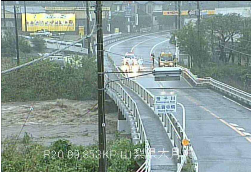
国道20号 法雲寺橋の一部損壊の状況
