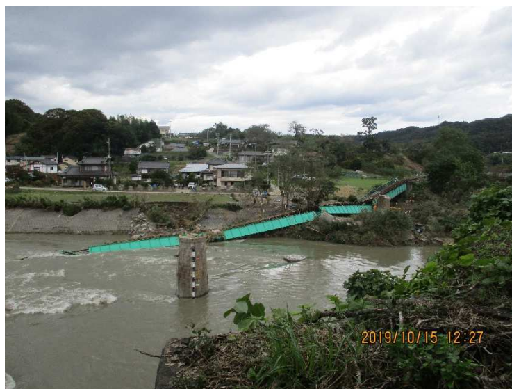
水郡線落橋(大子町袋田地内)
