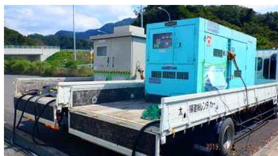
仮設発電機によるバックアップ状況
