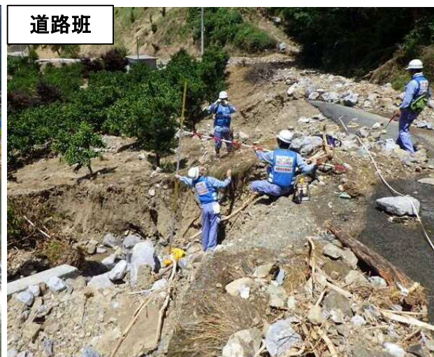
被災状況調査（宇和島市）
