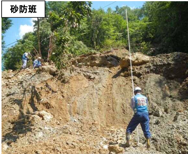
被災状況調査(岡山県新見市)
