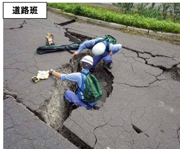
道路の被災状況調査
