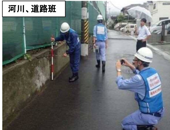
中学校の被害状況調査
