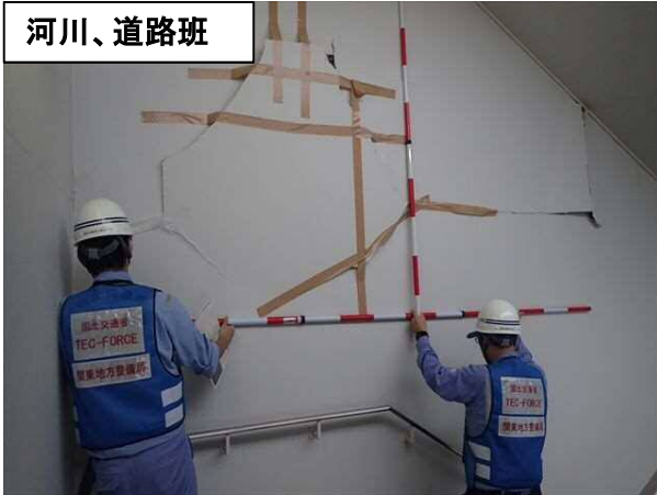
箕面市役所の被害状況調査
