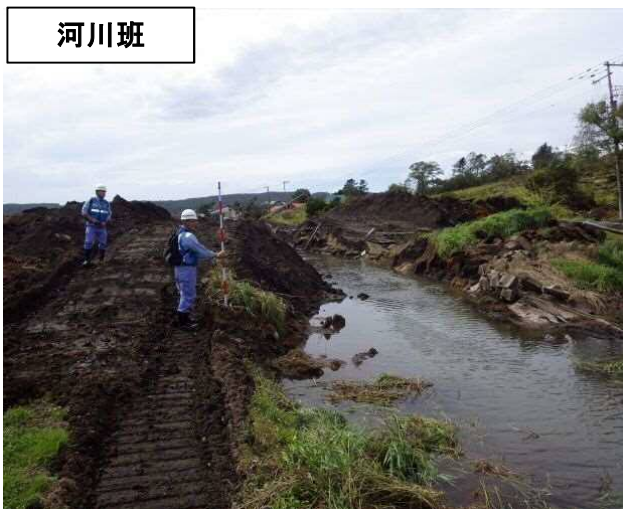
河川の被災状況調査
