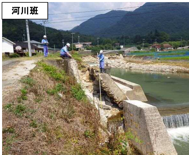
被災状況調査（広島市）
