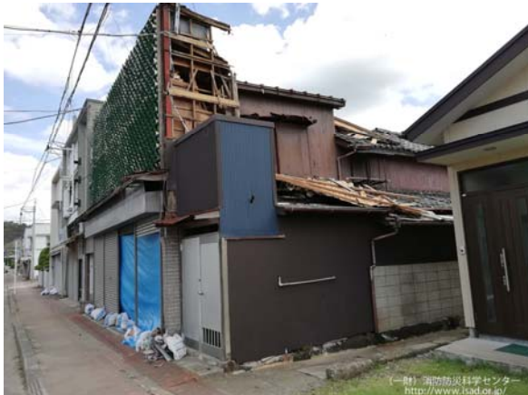
図2-2 台風15号の被害（住宅被害）
