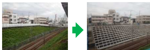
落石等防止設備（法面固定）
