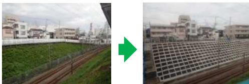
落石等防止設備（法面固定）
