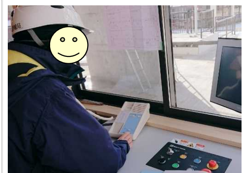
保安装置の 動作確認
