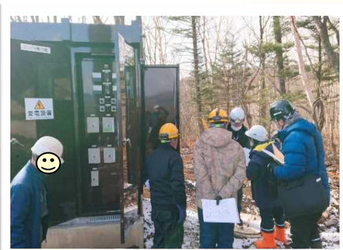
変圧器の 状態確認
