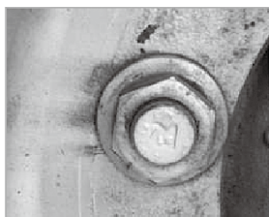
さび汁が流出した痕跡
