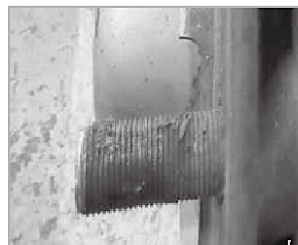
ボルトに著しいさびや汚れの付着
