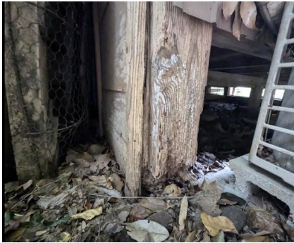
蟻害・腐朽状況
