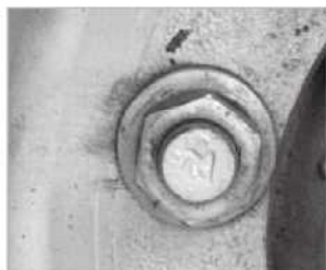
さび汁が流出した痕跡
