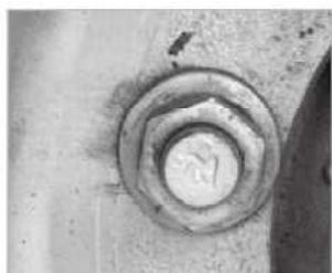
さび汁が流出した痕跡
