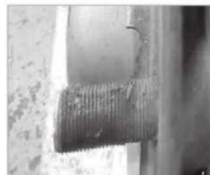
ボルトに著しいさびや汚れの付着
