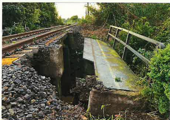
⑧成田線 下総橋～下総豊里駅間 橋梁設備損傷
