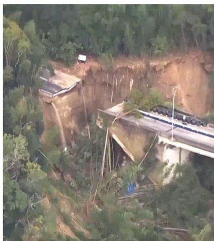
道路損壊(千葉市緑区越智町)
