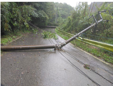
電柱倒壊(市原市外部田)
