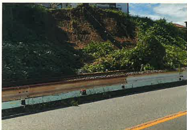
⑩久留里線 祇園～上総清川駅間 土砂流入
