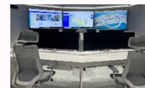
遠隔監視センター
