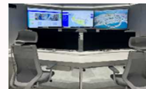
遠隔監視センター
