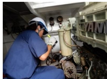
〔訪船指導（エンジンルーム確認）〕
