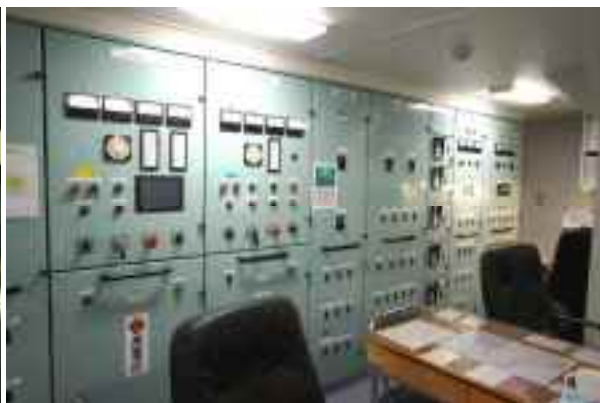
【エンジンコントロールルーム】
