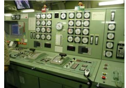
機関制御室のコントロールパネル
