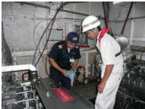
出港前に機関室の安全点検
