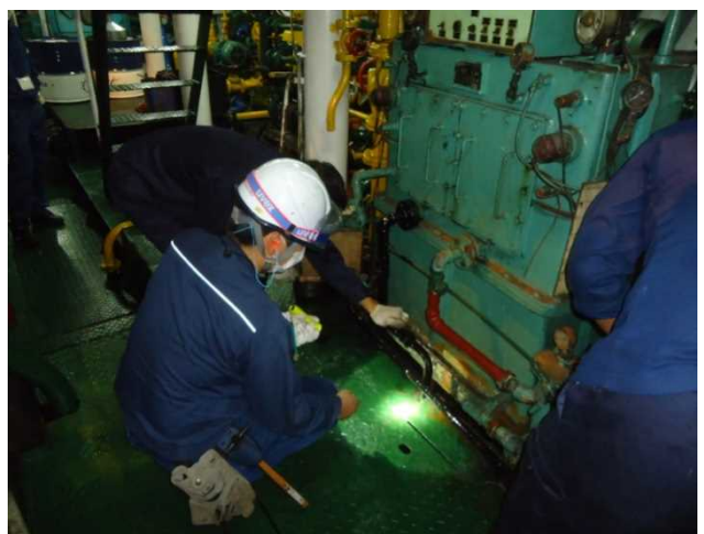
船内巡視（機関室）
