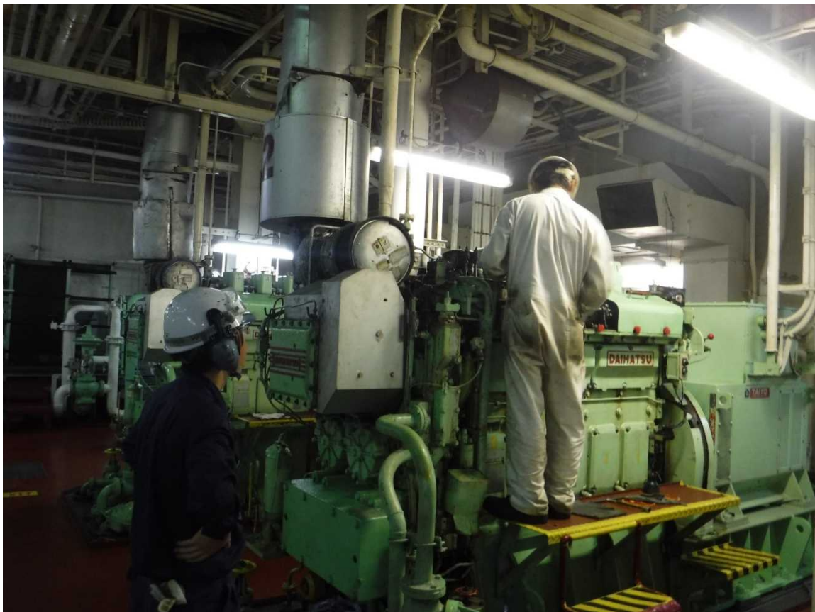
発電機を検査する外国船舶監督官
