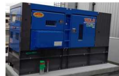
非常用電源設備
