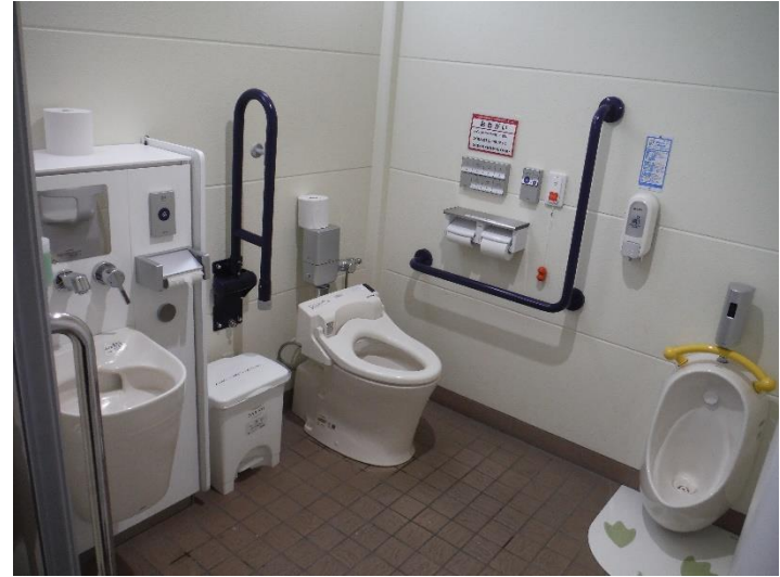
オストメイト施設・子ども用施設付きトイレ（「道の駅」たるみずはまびら）
