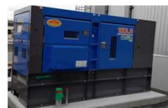
非常用電源設備
