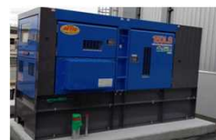
非常用電源設備
