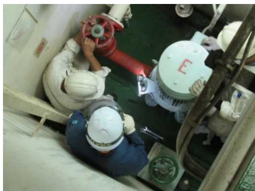
非常用消火ポンプの圧力検査
