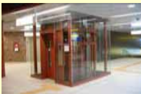
エレベーター
