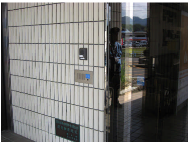
玄関口に設置された押しボタン
