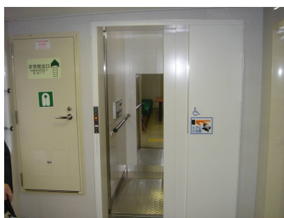
エレベーター
