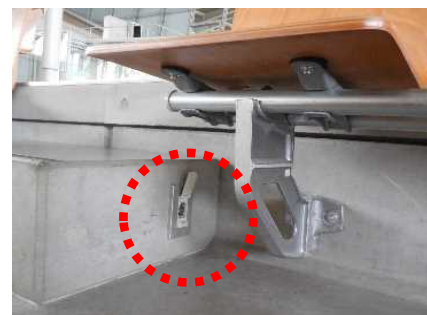
集団補聴設備の設置
