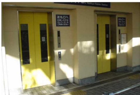
(旅客施設の エレベーター)
