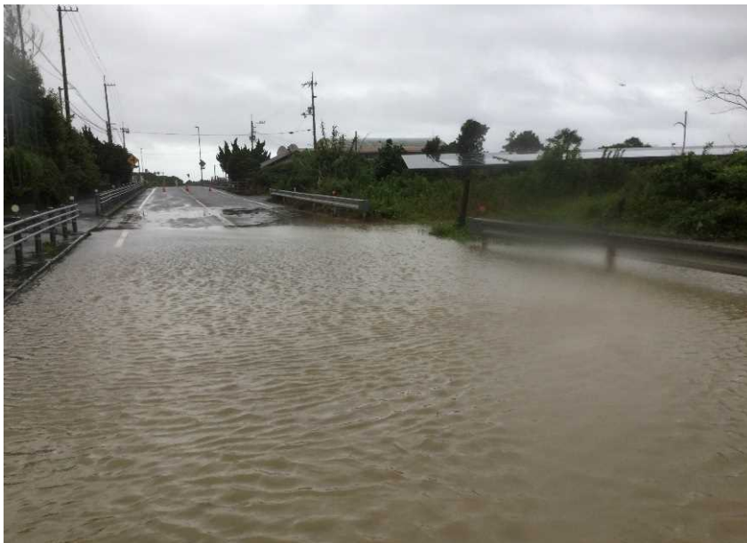
令和元年7月 冠水(国道55号 室戸市)
