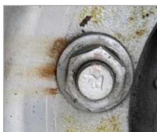
さび汁が流出した痕跡
