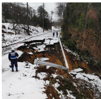
道路被害状況の調査
