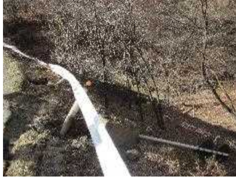
写真 24 なぎ倒されたガードレール
