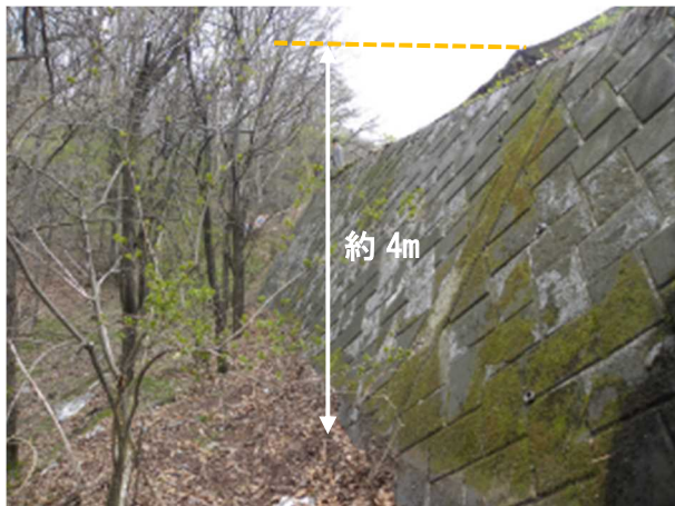
写真 26 転落地点（路面から約 4 m）
