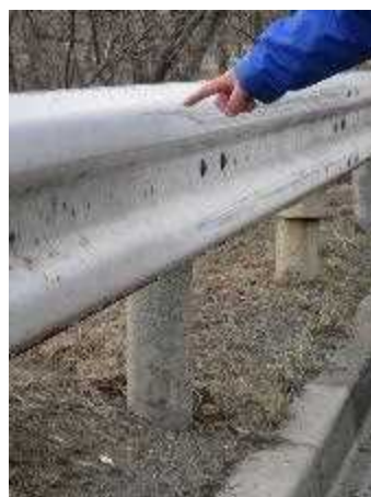
写真 20 ガードレールの傷跡
