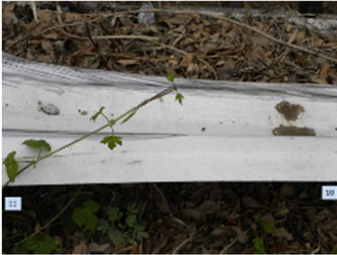
写真 25-5 ガードレール傷跡⑤
