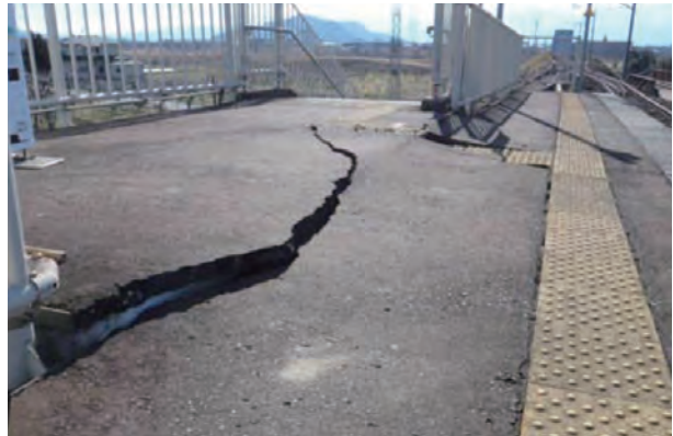
写真 2.6.4 向瀬上駅ホーム亀裂
