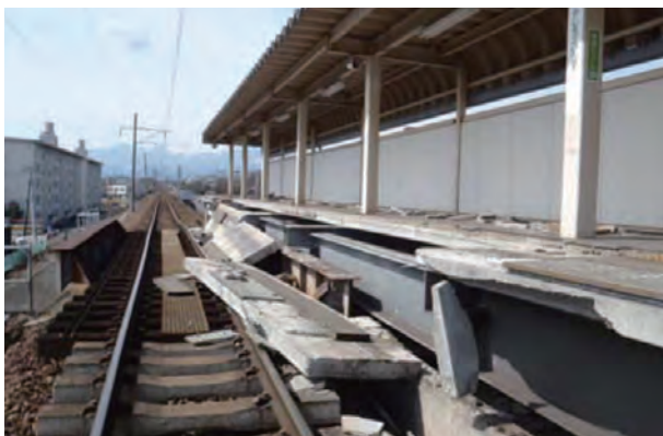
写真 2.6.3 福島学院前駅ホーム崩落
