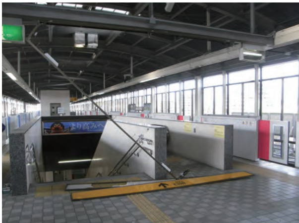
写真 2.5.10 案内掲示器等の脱落状況
