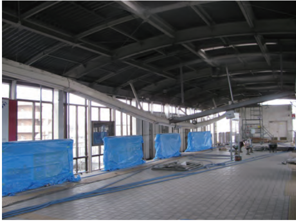
写真 2.5.9 照明器具の損傷状況
