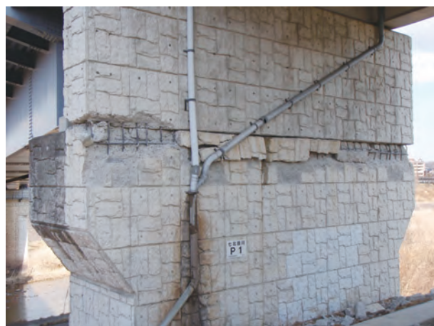
写真 2.5.3 七北田川橋りょうの損傷状況
