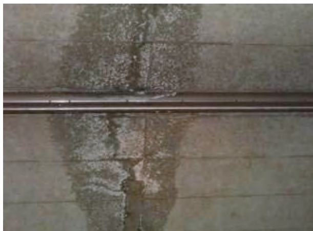
写真 2.5.6 トンネル内の漏水状況
