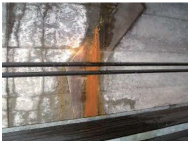
写真 2.5.7 トンネル内の漏水状況
