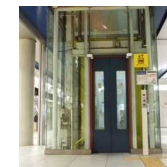
【エレベーター】
