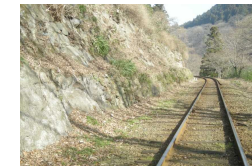
【落石等防止設備】
