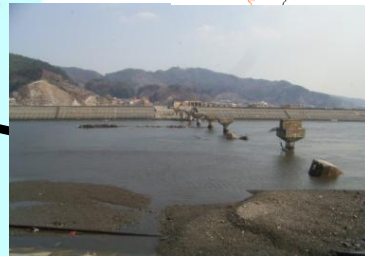
大槌川橋りょう 橋桁流出 (吉里吉里～大槌間)
