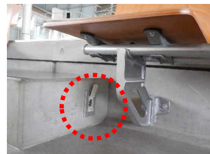
集団補聴設備の設置
