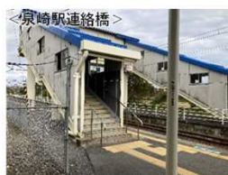
< 泉崎駅連絡橋 > 連絡橋の誘導ブロック未設置、内方線の未設置
