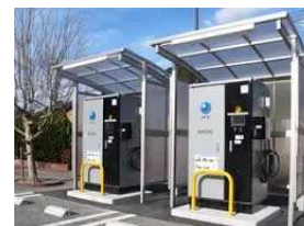
充電施設 蓄電池
