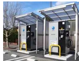
充電施設 蓄電池
