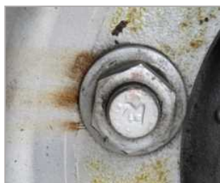
さび汁が流出した痕跡
