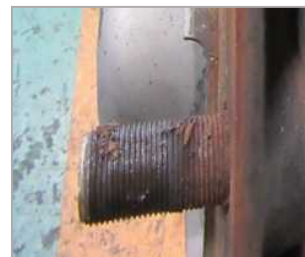
ボルトに著しいさびや汚れの付着
