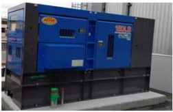
非常用電源設備
