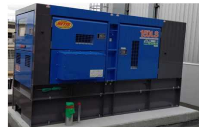
<非常用電源設備>
