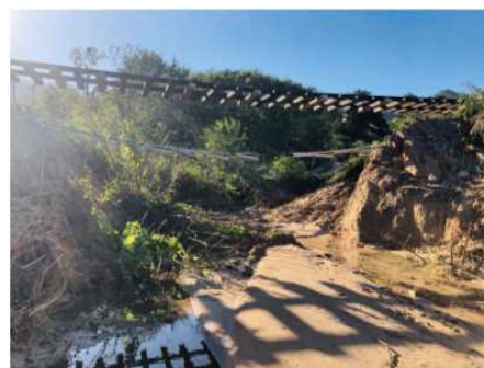
盛土が流出した線路
